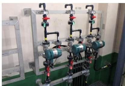
次亜塩素酸ナトリウム 注入設備
