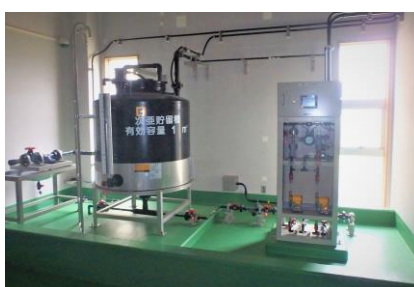
次亜塩素酸ナトリウム 貯蔵槽、注入設備
