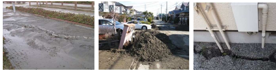
写真 1-2-1. 久喜市南栗橋における被害状況
