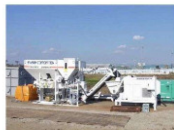
コンパクト施工システムのプラント設備 (住宅地での施工を想定したコンパクトなプラント設備)
