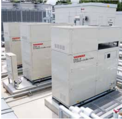
[ガスで発電・熱を有効利用] ガスコージェネレーションシステム
