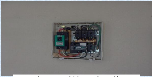
電気設備の損傷
