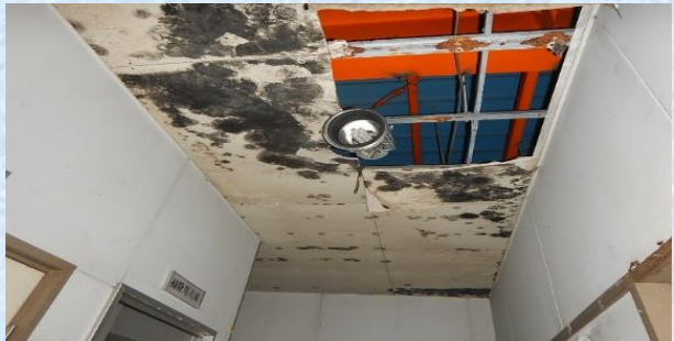
天井材の一部脱落
