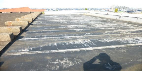
屋上の防水層の劣化
