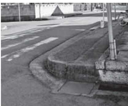
▲イトーピアの車道と歩道の段差
