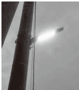
電球切れの心配が減ったLED防犯灯
