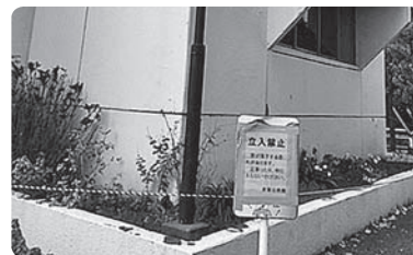
青葉公民館の剥がれ落ちた壁にロープが張られている。
