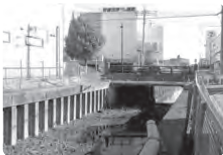
浚渫が急がれる五領橋付近
