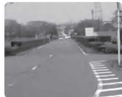
路面が波を打っている状況の62号線
