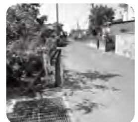
側溝整備が待たれる 除堀地内市道久喜3162号線
