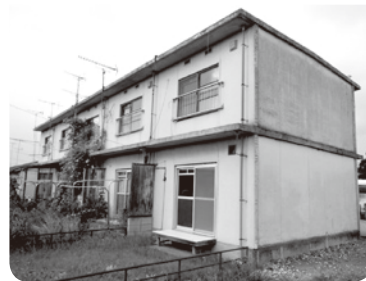
老朽化著しい市営住宅
