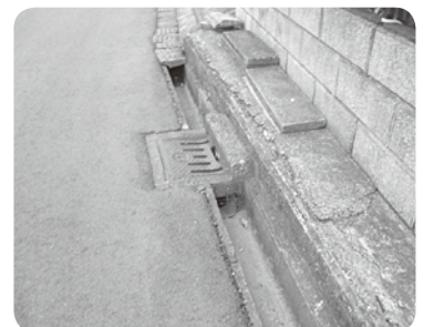
本町 2 丁目の冠水対策が必要な側溝
