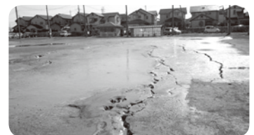
再液状化防止対策地域 南栗橋スポーツ広場 (2011.3.12 撮影)
