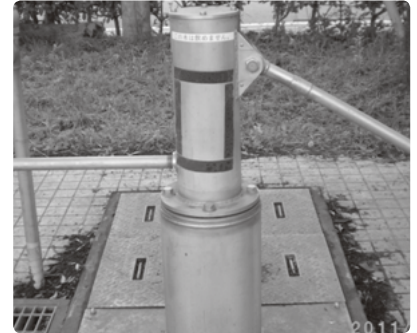
清久小学校に設置の『防災井戸』
