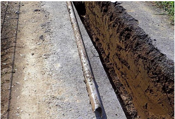
老朽化した配水管です。
