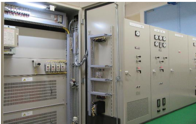
浄水場を運転するための電気盤です。
