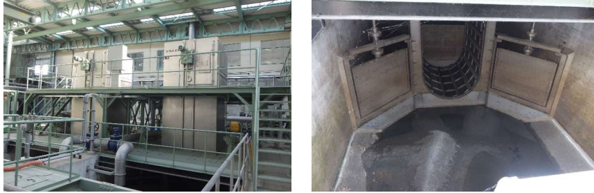
「③夾雑物の削減」の施策として雨水用自動除塵機を作りました。
