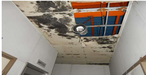
天井材の一部脱落
