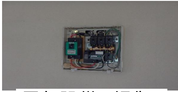
電気設備の損傷
