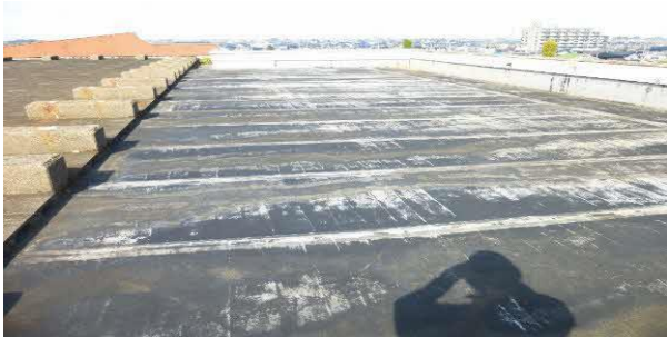
屋上の防水層の劣化
