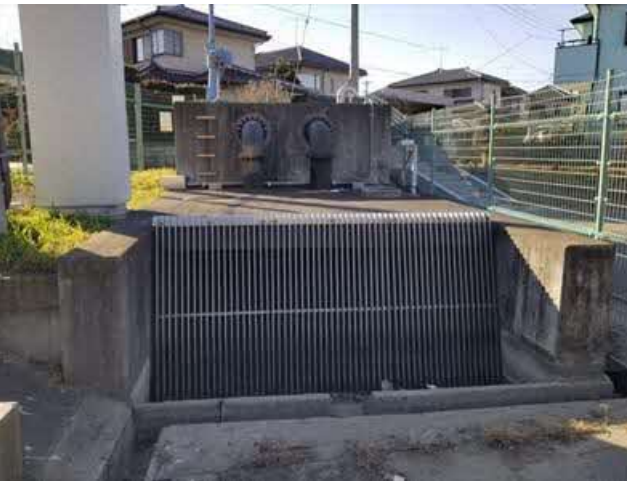
鷺宮5丁目地区排水ポンプ施設
