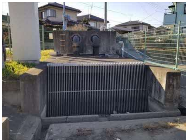
鷺宮5丁目地区排水ポンプ施設
