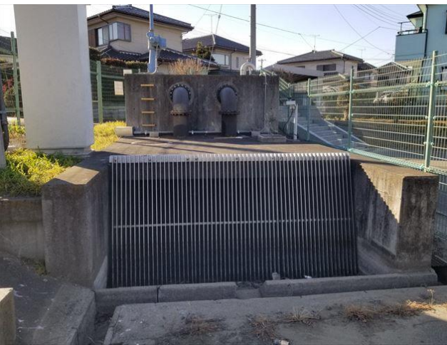
鷺宮5丁目地区排水ポンプ施設
