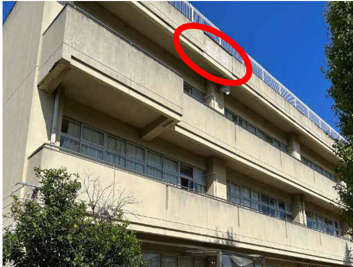
↑ ①外壁落下時の状況
