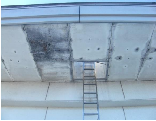
体育館 屋根の劣化
