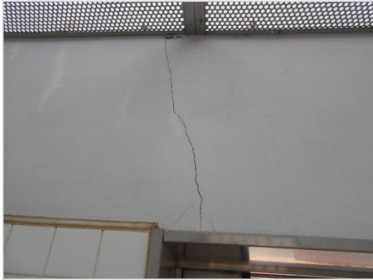
管理棟 壁のクラック
