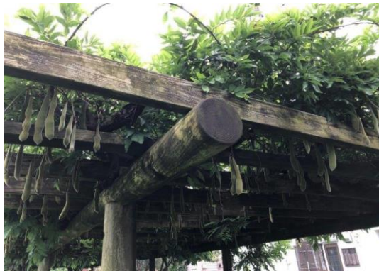
休憩所 梁の腐朽
