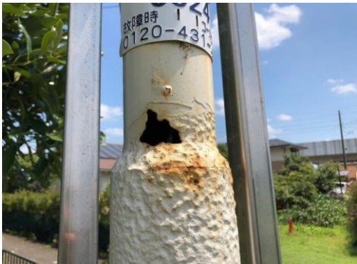
照明灯 柱の錆
