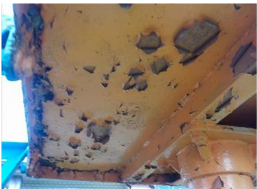
滑り台 塗装剥離
