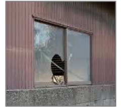
窓が割れた管理不全空家
