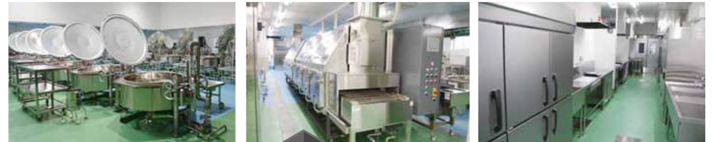
煮炊き調理室 蒸気回転釜18台 SV ロースター 食物アレルギー食専用調理室
