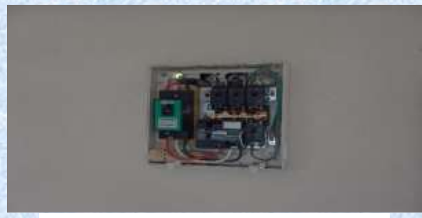
電気設備の損傷
