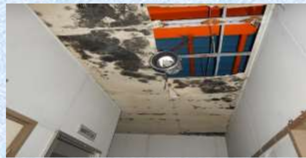
天井材の一部脱落
