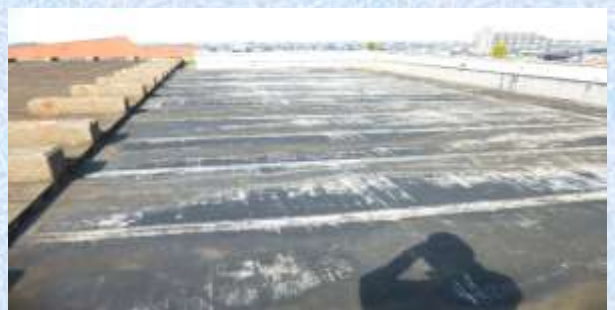
屋上の防水層の劣化
